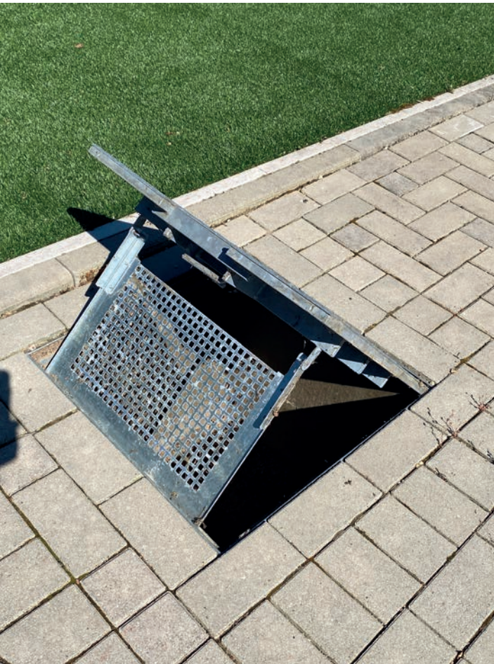
Kabelverteilerschacht in gepflasterter Nebenfläche. Deckel aufgestellt.
